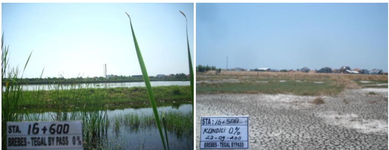
圖 7.2 Brebes – Tegal Bypass 積水路段 乾濕季之路堤施工條件比較
